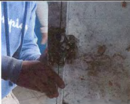
Foto 3: Sustrucción de chapa
